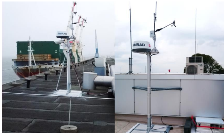
Abbildung 54: Stationäre NaviBoxen der Referenzwasserstraße von LABSKAUS in Cuxhaven (links) und Brunsbüttel (rechts)
